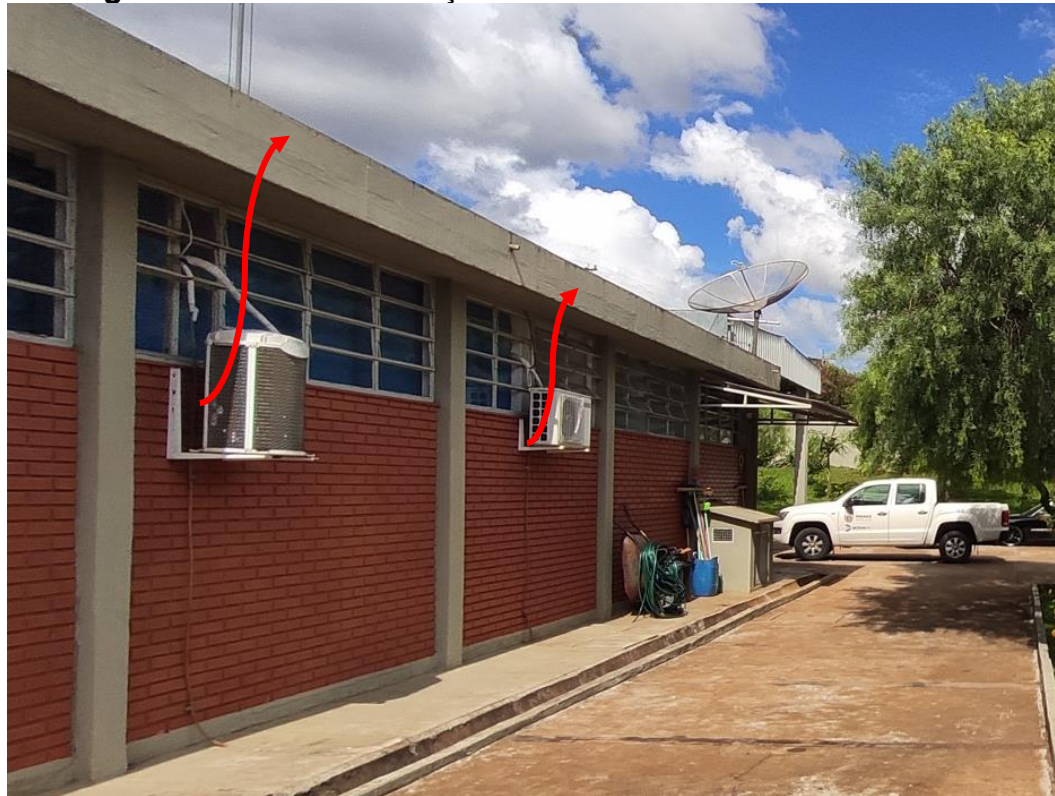
Figura 9: Saída da tubulação do ar condicionado
