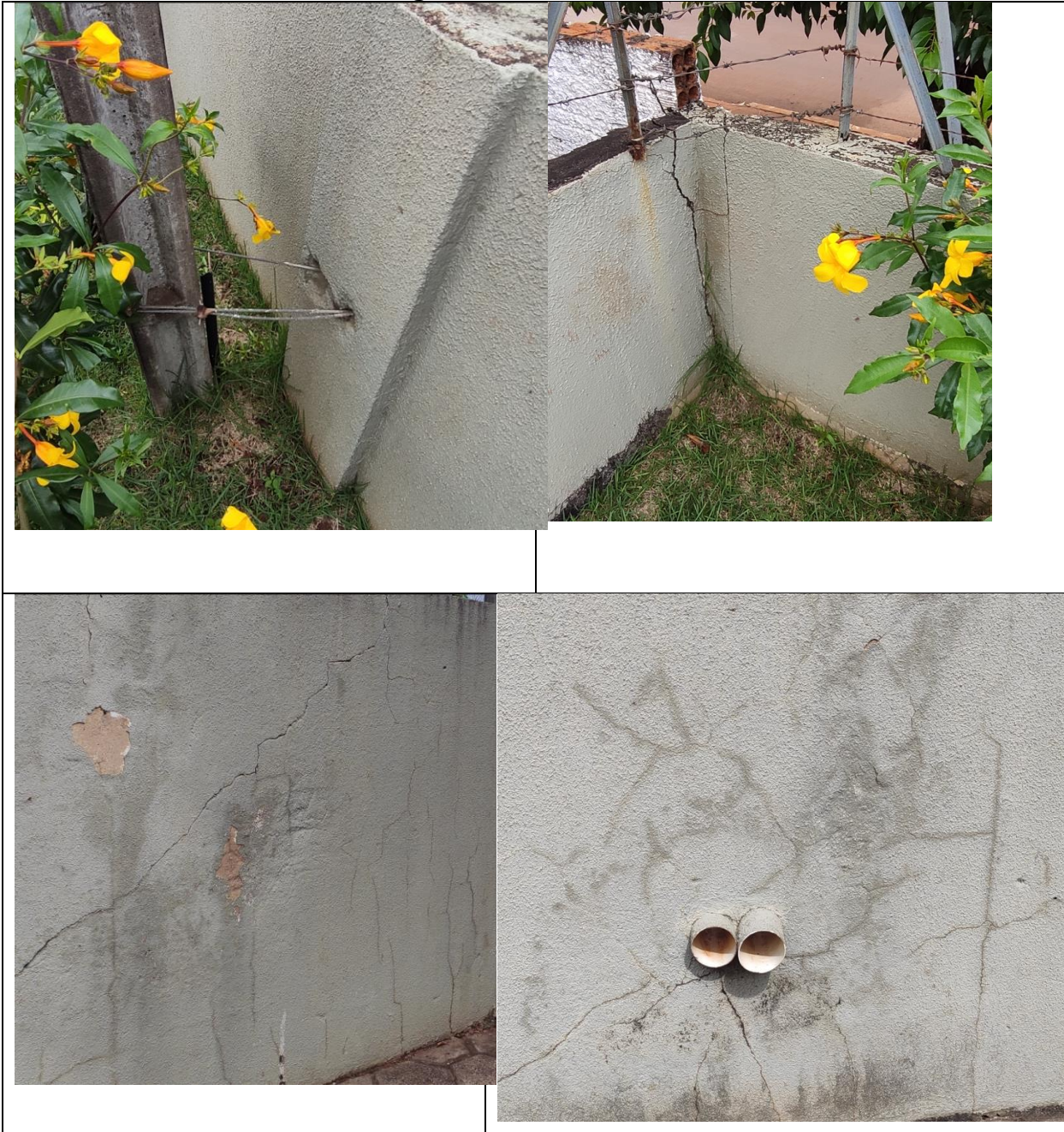
Figura 5 – Estado atual do muro
